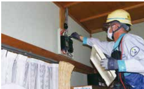
家庭内の配電盤の確認作業を行う四国電気保安協会の山下耕二さん
