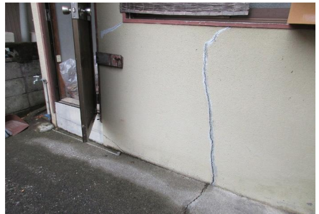
外壁のひび割れ
